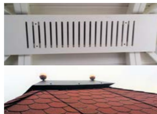
Dachabzug (innen & außen)
